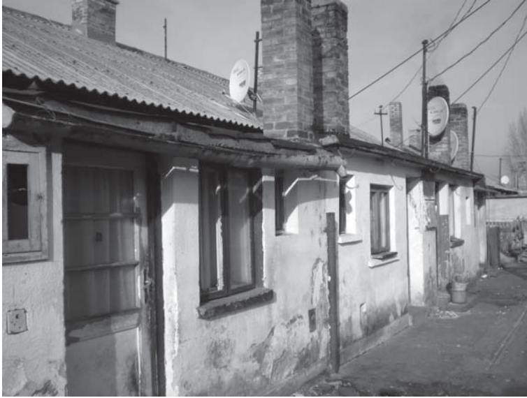
Figure 20. Wet Walls in Mésztelep
